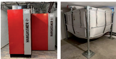
Installationsbeispiel: Hargassner Kombianlage Stückgut/Pellets inkl. Sacksilo zur Pelletslagerung
